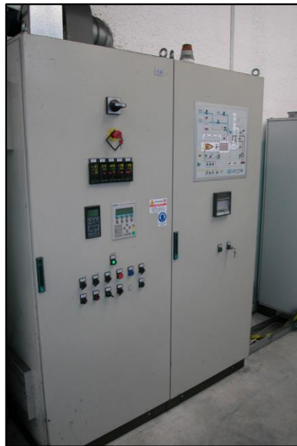
Panel de control en armario de distribución
