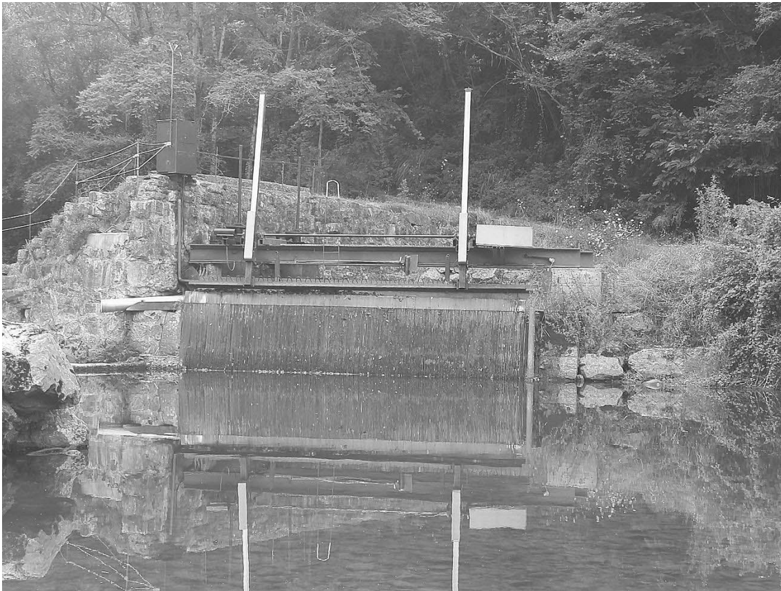
Figura 3-2: Vista exterior de la reja y de la toma de agua
