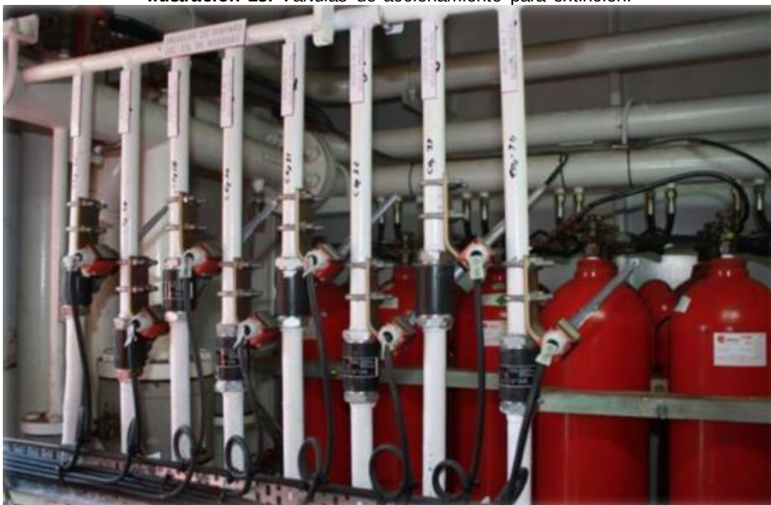
Ilustración 13: Válvulas de accionamiento para extinción.
