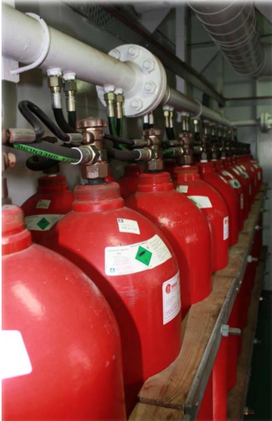
Ilustración 14: Almacenamiento de botellas de CO 2 .
