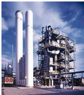
Figura 151: Planta de reformado de gas natural.
