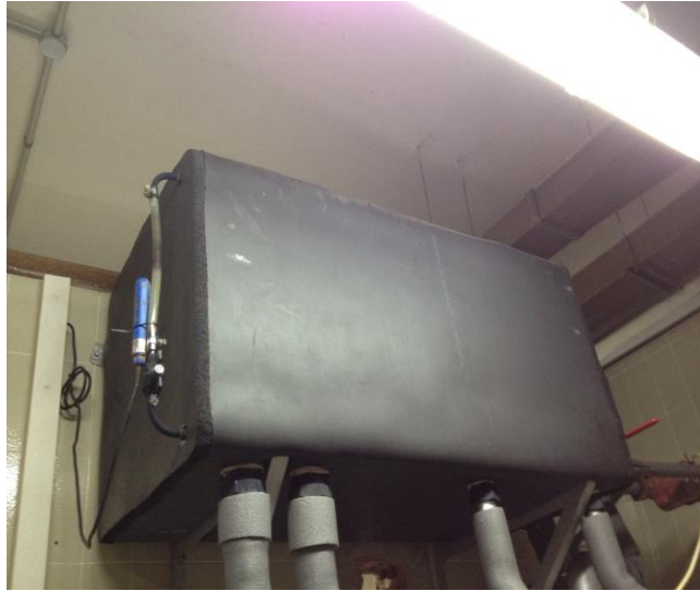
Figura IV.12. Tanque de mezcla.
