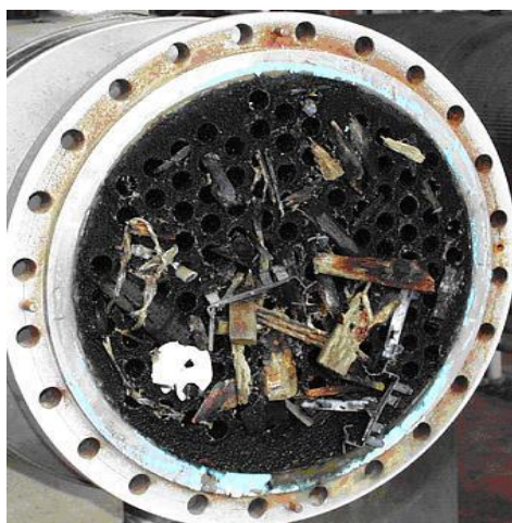
Figura II.7. Acumulación de partículas sólidas en la placa de un intercambiador de calor tubular (H&C Heat Transfer Solutions Inc. 2013).
