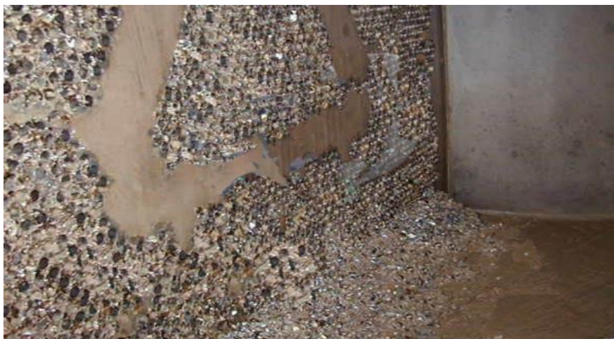
Figura II.1. Presencia de mejillones en la caja de agua de un condensador (Tube Tech International Ltd. 2015).
