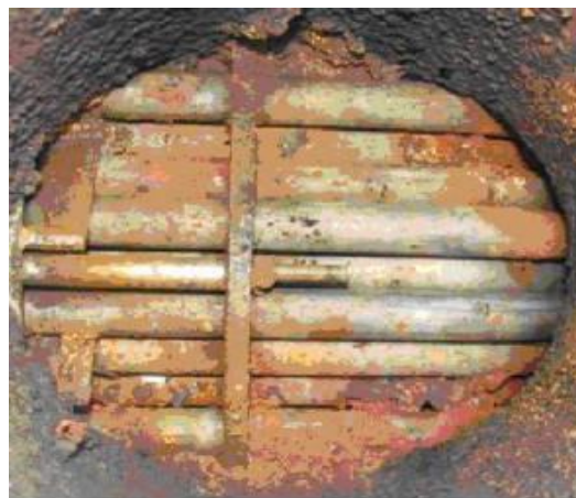
Figura II.4. Óxidos de corrosión en los tubos de un intercambiador de calor (H&C Heat Transfer Solutions Inc. 2013).
