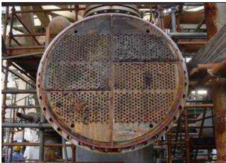
Figura II.2. Intercambiador de calor tubular en mantenimiento por presencia de biofouling en los haces tubulares (Merus the water conditioner Company 2013).
