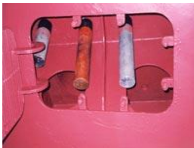
Figura II.30. Ánodos de zinc y cobre situados en la toma de agua de mar de un buque (Cathwell 2011).
