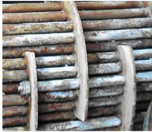
Figura II.6. Sales precipitadas en los tubos de un intercambiador de calor (H&C Heat Transfer Solutions Inc. 2013).
