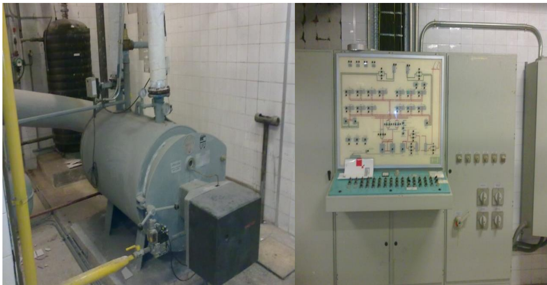
Figura IV.11. Caldera auxiliar y panel de control de la central térmica de la E.T.S. de Náutica.
