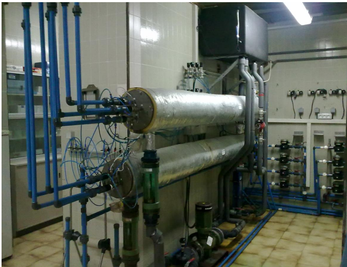
Figura IV.3. Planta piloto de intercambiadores de calor-condensadores.
