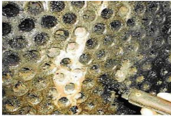
Figura II.3. Residuo de hidrocarburo en los tubos de un intercambiador de calor (H&C Heat Transfer Solutions Inc. 2013).
