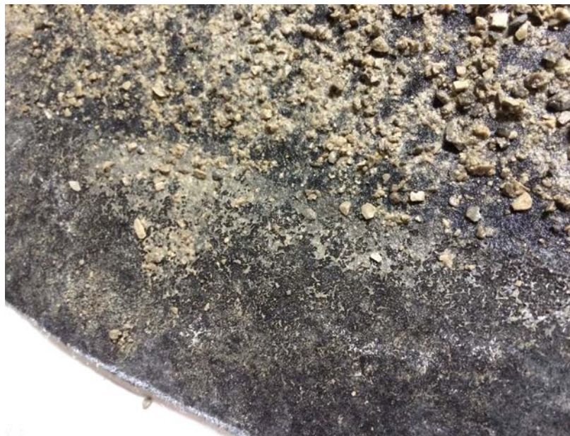
Figura 34.- Detalle del daño producido por la filtración
