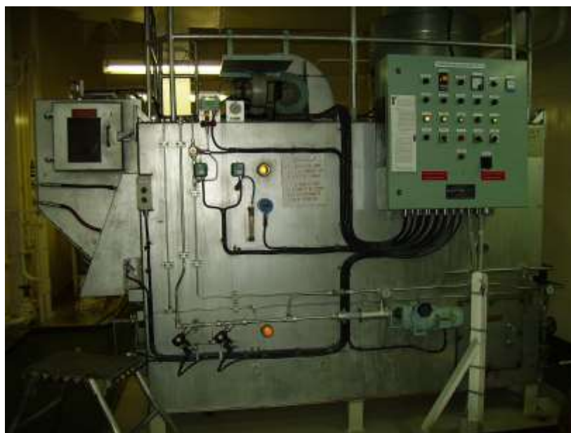
Figura 7.21. Foto de Incinerador de basura y sludge. (JORA 2008).
