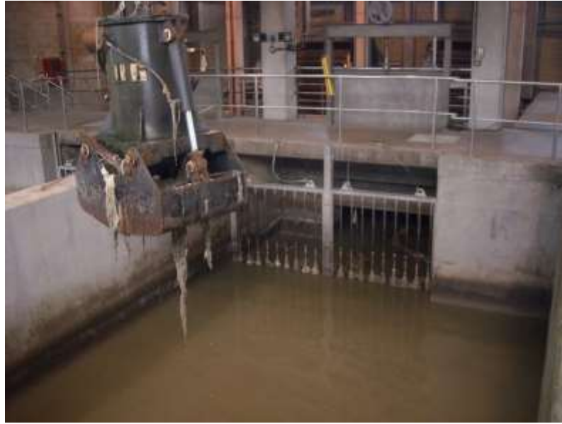
Figura 7.3. Recogida de residuos de gran tamaño en EDAR. (JORA 2011).
