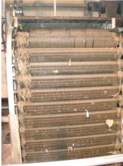
Figura 7.1. Tamiz de recogida de residuos sólidos en EDAR. (JORA 2011).
