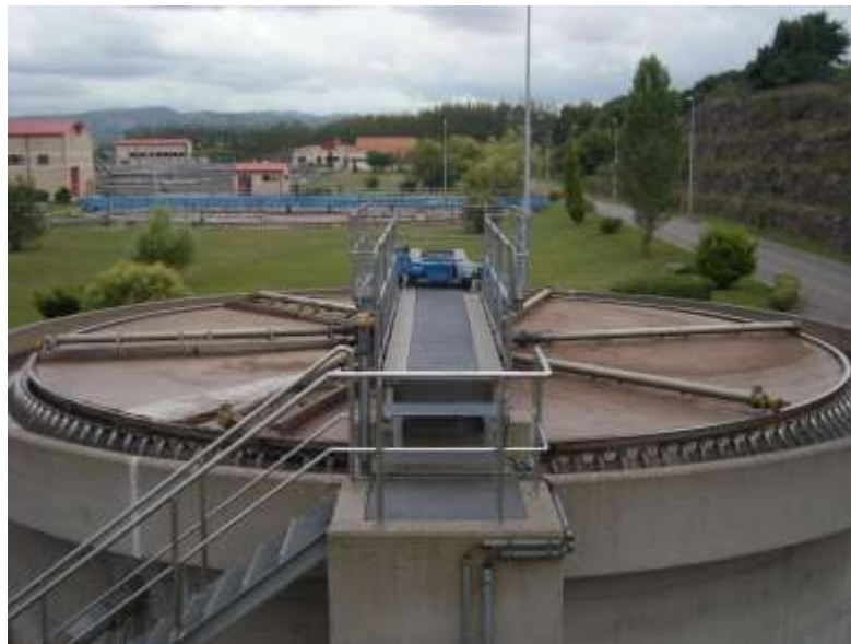
Figura 7.2. Balsa para la eliminación de contaminantes biológicos y químicos en EDAR. (JORA 2011).
