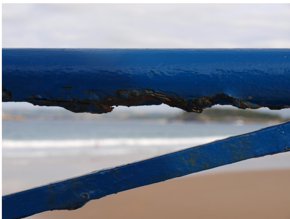
Figura 48. Corrosión en una barandilla en Avenida Manuel García Lago (Santander, Cantabria)
