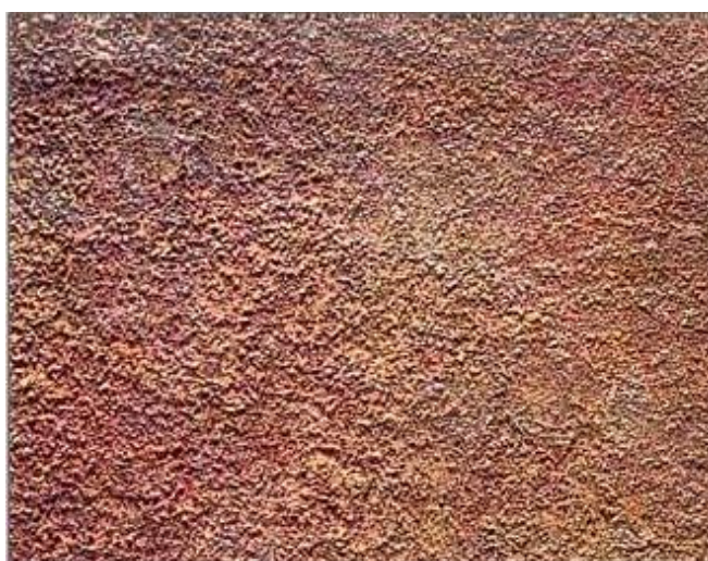
Fig 55. Pieza con una grado C de corrosión [ http://www.ingepint.cl/I-T-grados-corrosion.html ]
