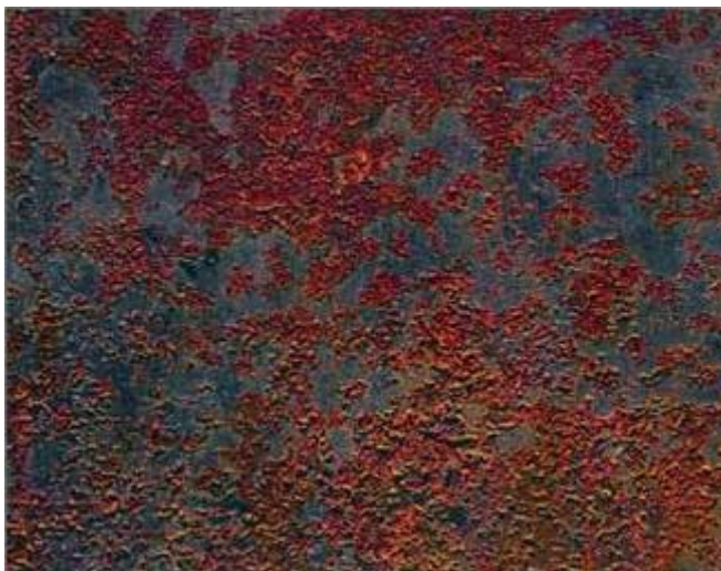
Figura 54. Pieza con una grado B de corrosión [ http://www.ingepint.cl/I-T-grados-corrosion.html ]
