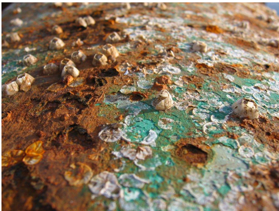
Fig 68. Corrosión microbiológica en un elemento metálico
