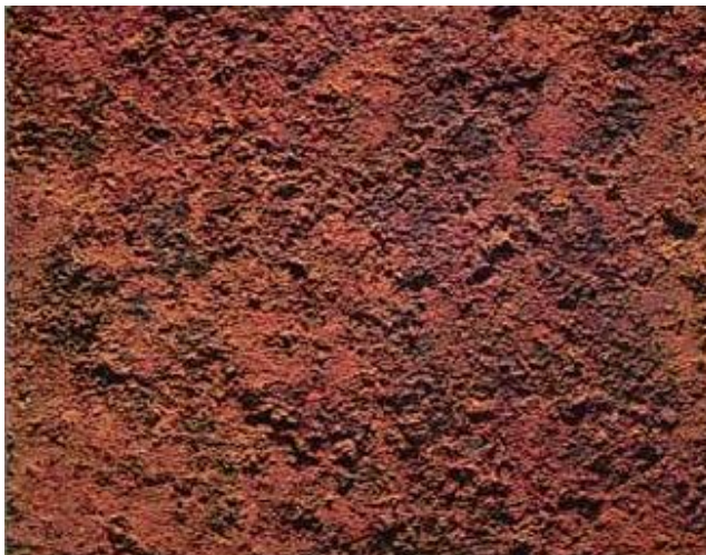
Fig 56. Pieza con una grado D de corrosión
