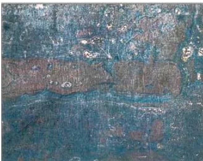
Figura 53. Pieza con un grado A de corrosión [ http://www.ingepint.cl/I-T-grados-corrosion.html ]
