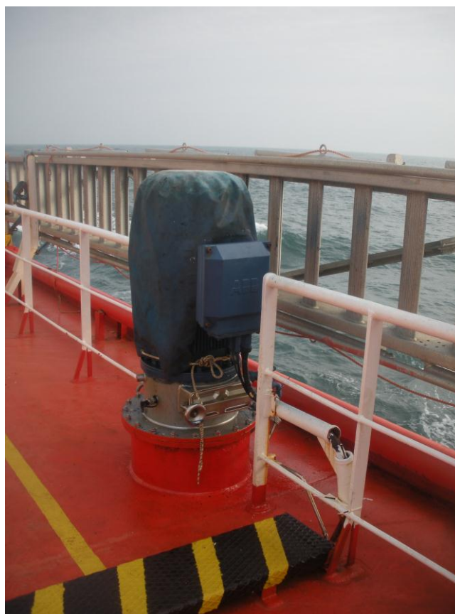
Figura 23 – Motor eléctrico de la bomba, sobre la cubierta principal
