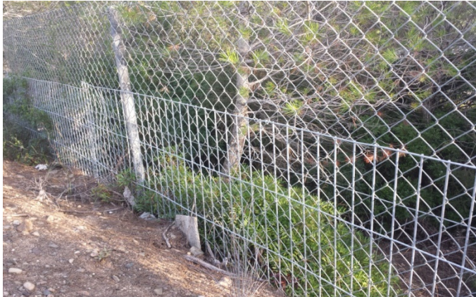
Ilustración 15 Valla electro soldada.
