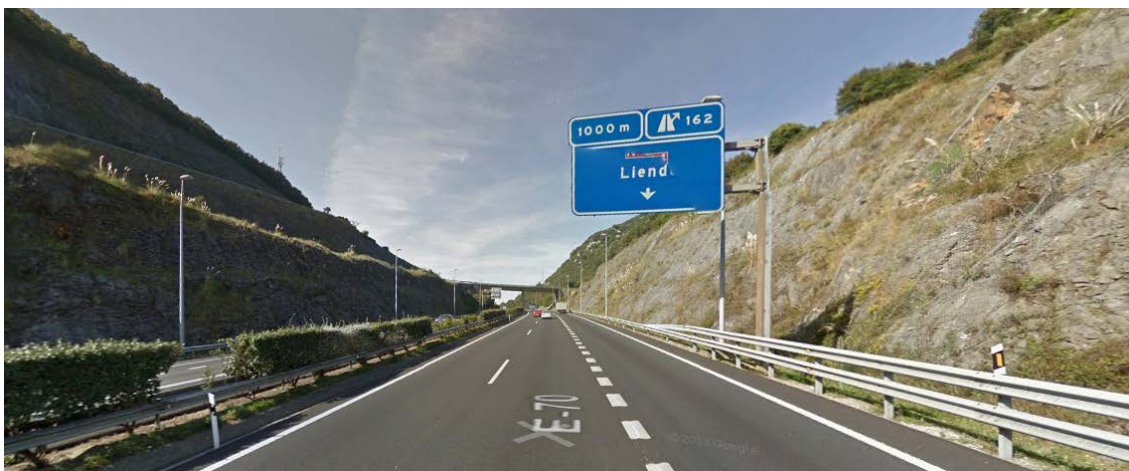
Ilustración 86 Desmontes de la A-8 a la altura del monte Candina. (23)
