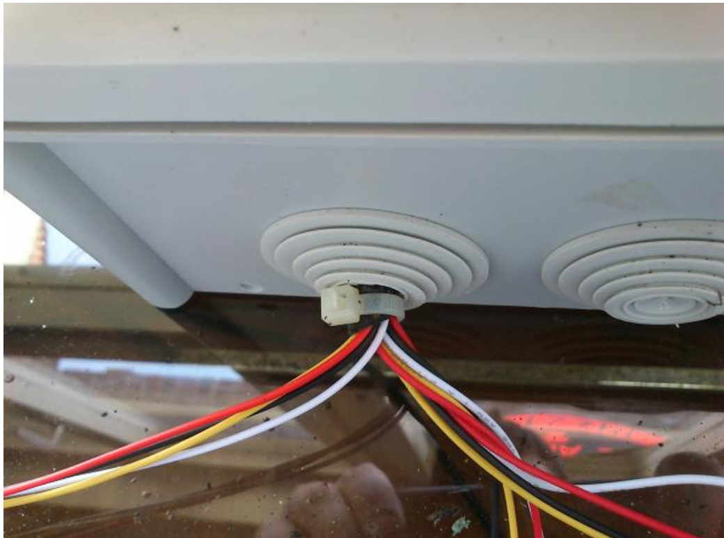
Figura 96 Salida de cables para sensores
