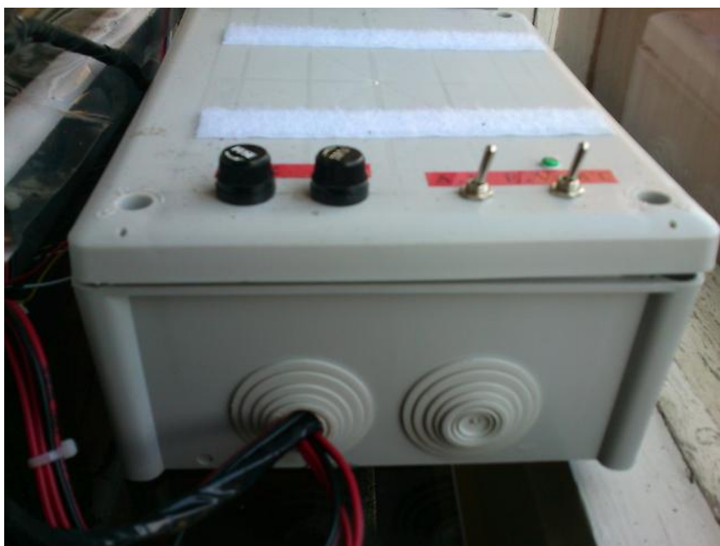
Figura 94 Interruptor, conmutador, fusibles y salida de cables corriente
