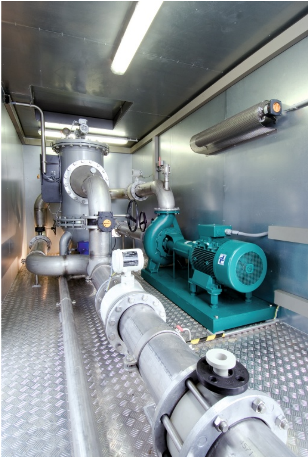
Ejemplo de Sistema de Tratamiento de Aguas de lastre que combina varias tecnologías, el Westfalia Separator BallastMaster ecoP
