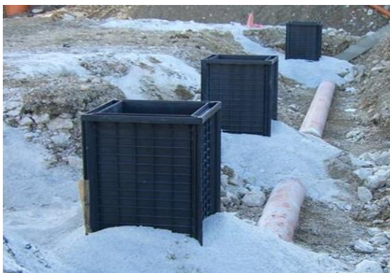
Arquetas y colector general.
