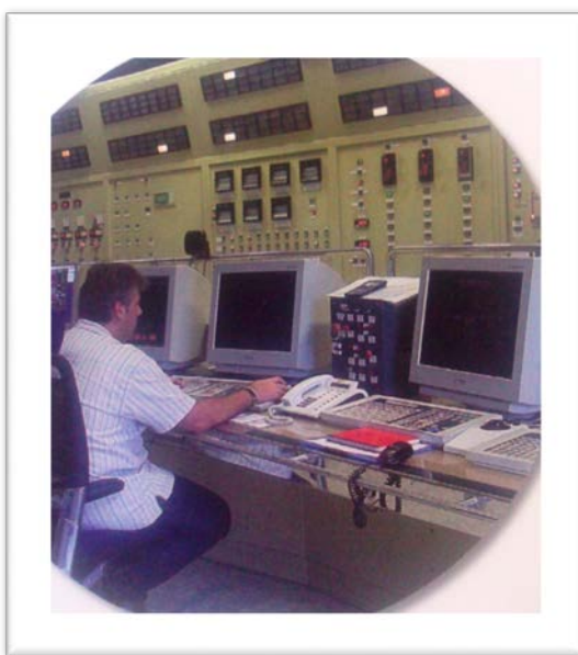
Figura 2. Sala de control de Solvay
