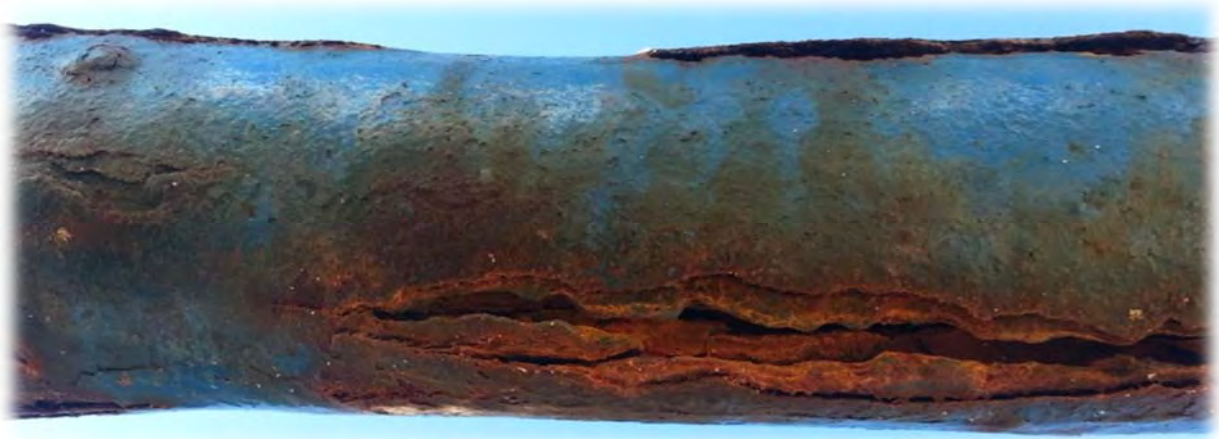
Figura 33. “Barandilla de acero al carbono sin mantenimiento con corrosión por erosión. Segunda playa del Sardinero Santander”
