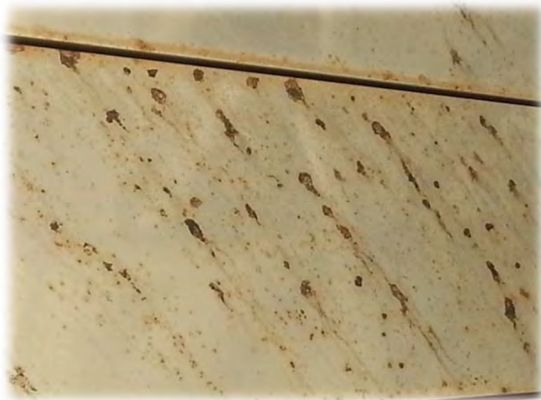
Figura 96. “Corrosión por picadura en la entrada del Palacio de Deportes en Santander”
