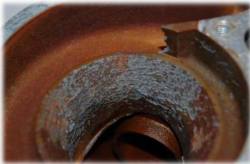
Figura 36. “Ejemplo de corrosión por cavitación”
