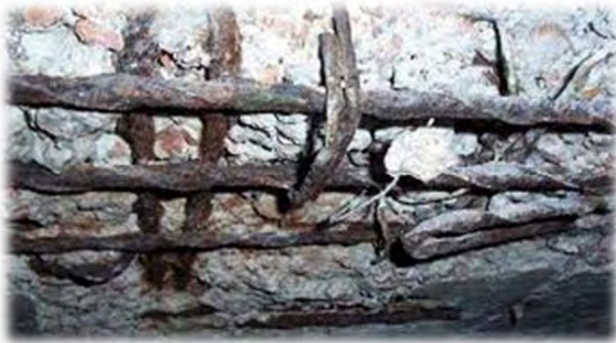
Figura 42. “Barras de acero corrugado bajo tensión en hormigón carbonatado”
