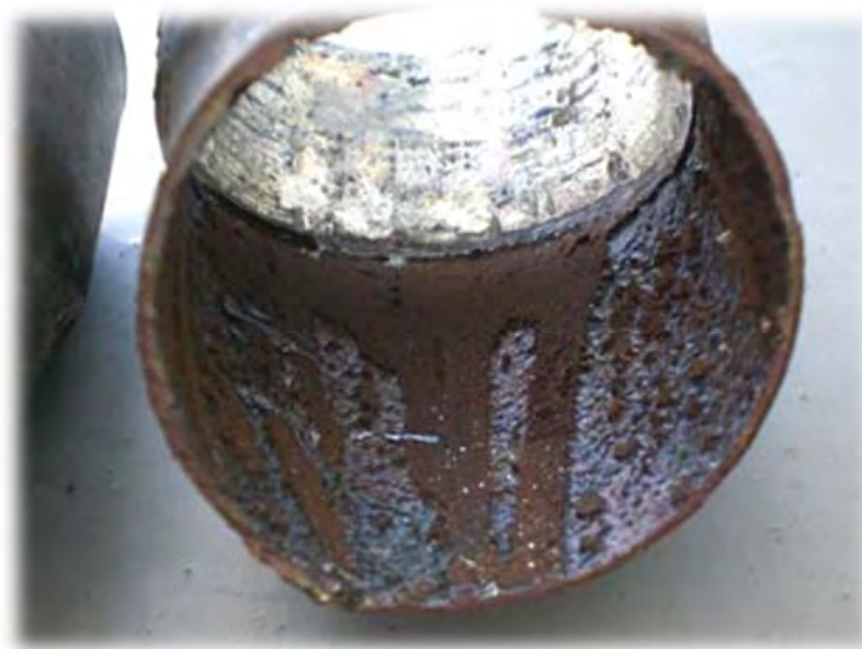
Figura 30. “Efecto de la corrosión erosión”
