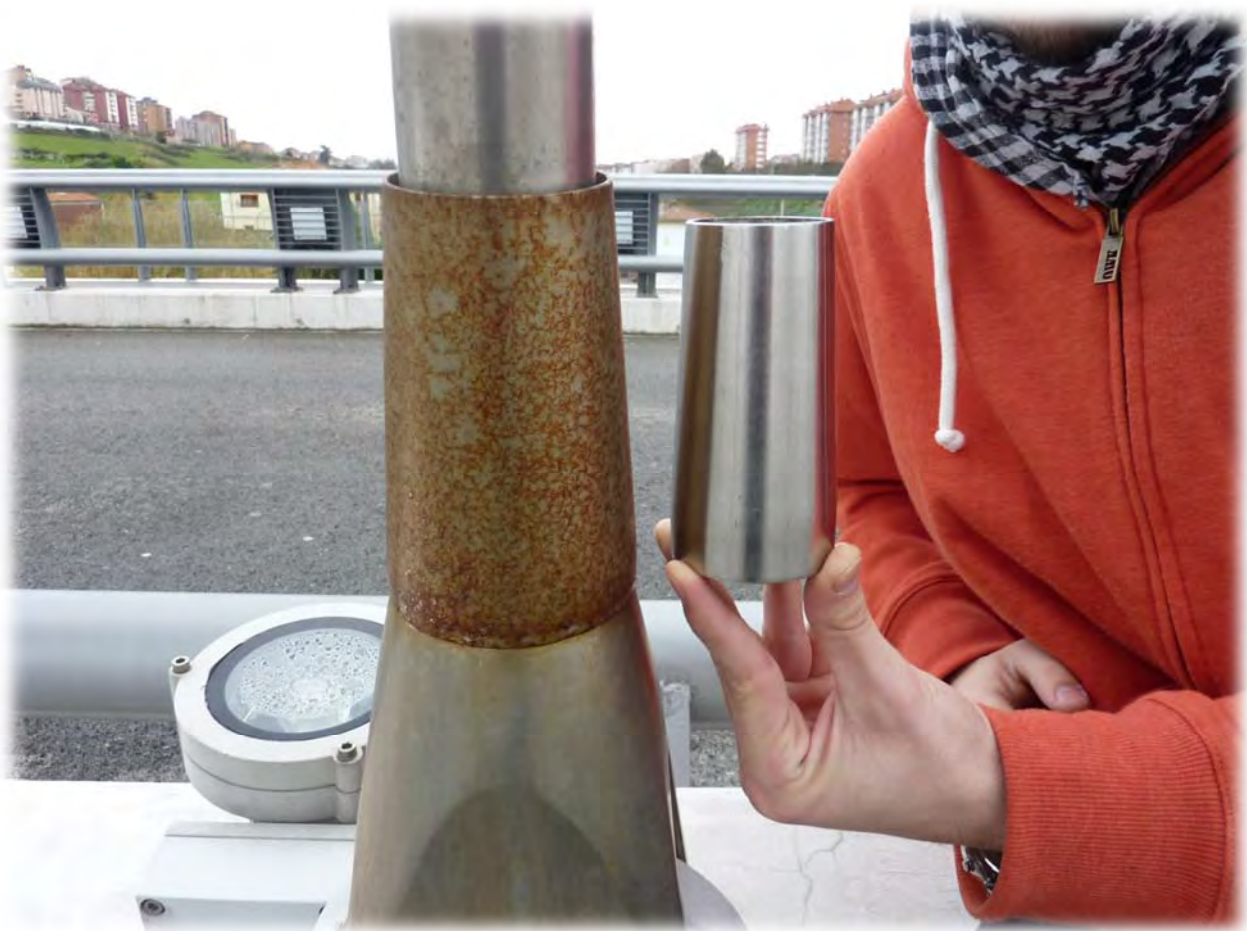
Figura 4. “Comparación de casquillos, con y sin ataque de corrosión por picadura”
