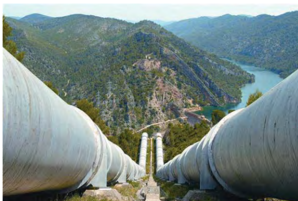
Figura A.52 - Ejemplo de tubería de presión
