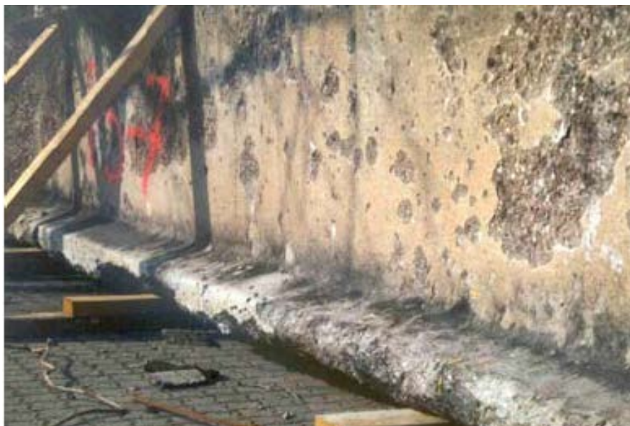
Figura 4. Desprendimiento en una viga de hormigón debido al spalling. (Fuente FEBELCEM)
