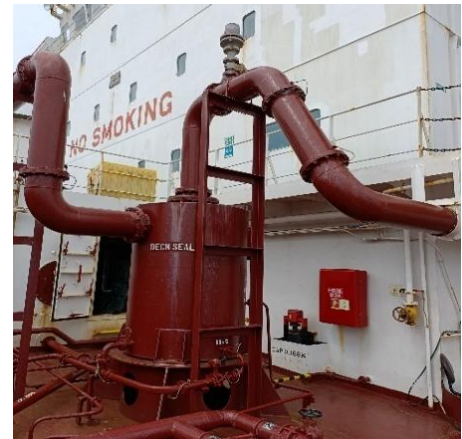
Imagen 11: Sello de agua de cubierta húmedo. Elaboración propia.
