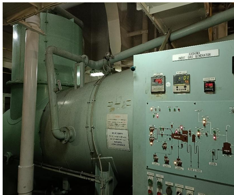
Imagen 7: Generador de gas inerte. Elaboración propia.
