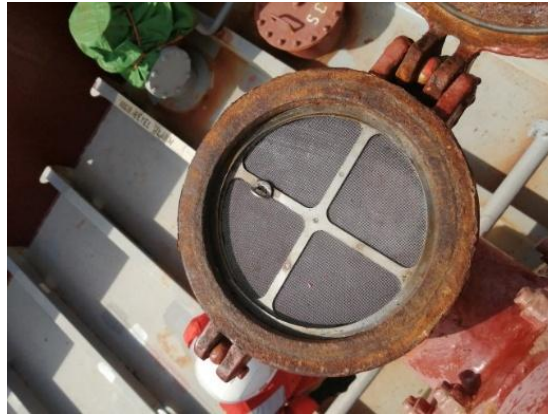
Imagen 24: Comprobación de válvula presión/vacío. Elaboración propia.
