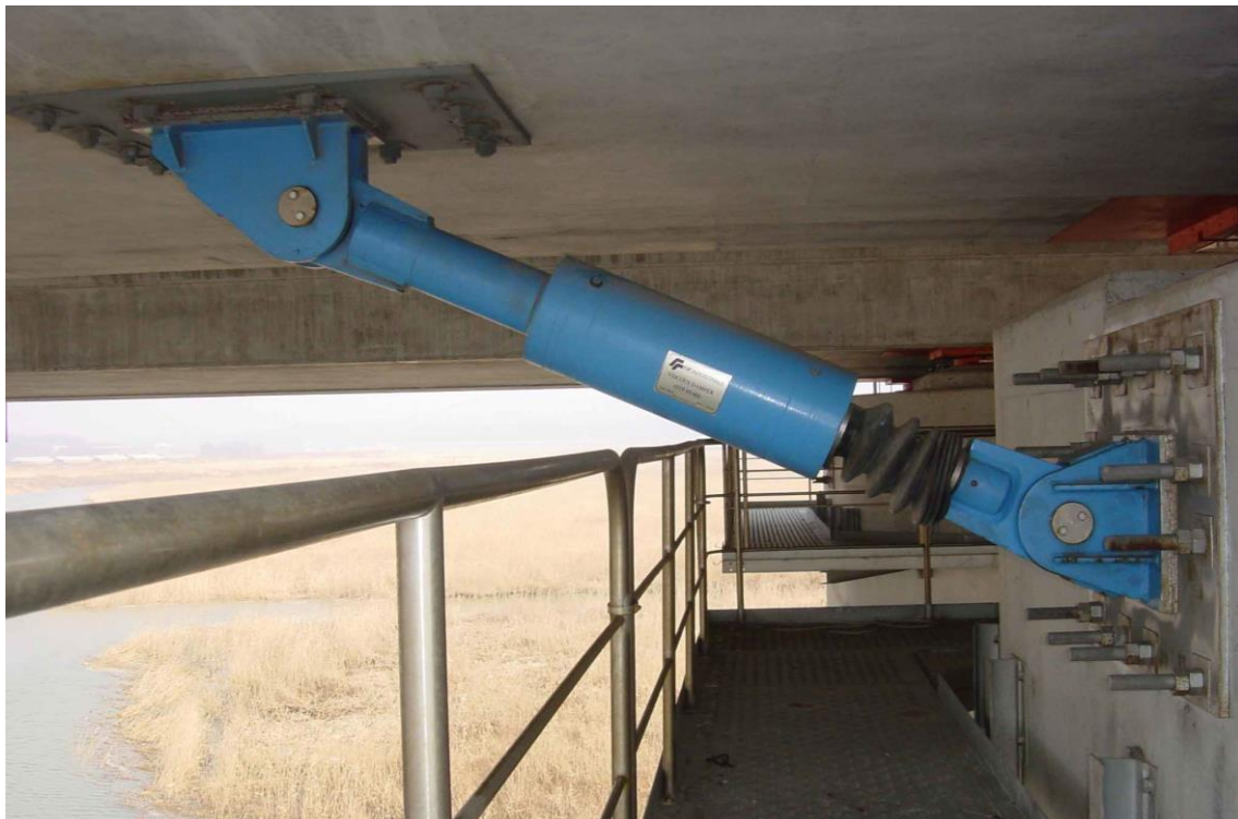
Figura 6.4 - Limitadores de deslizamientos longitudinales del tipo viscoso en el puente Chun-Su de Corea. 13 o Conferencia Mundial en Ingeniería sísmica.
