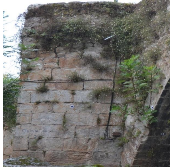
Grieta vertical en la parte superior de la pila
