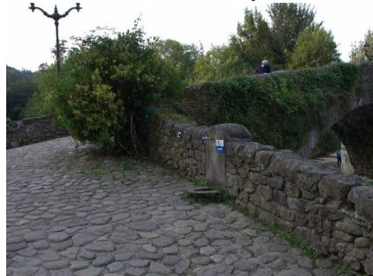
Crecimiento de un árbol en la plataforma, en la zona del estribo
