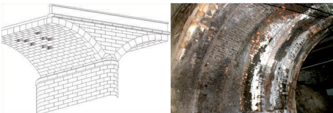
Figura 2-20: Deslizamiento de dovelas (izquierda) y humedades y eflorescencias (derecha) en bóvedas de fábrica [13].
