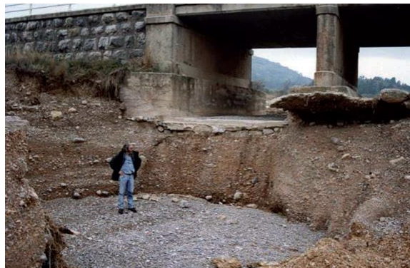
Figura 2-12: Socavación en pila [13].
