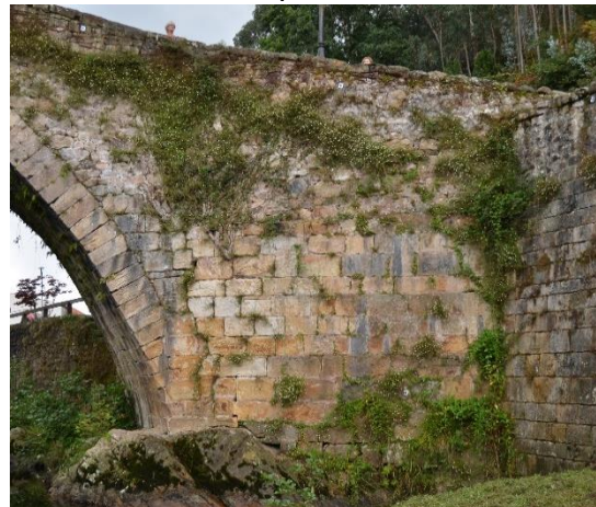
Fisura vertical inclinada en el estribo sur de la bóveda mayor
