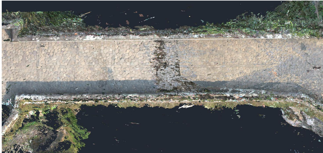
Deformación hacia el exterior del tímpano norte en la bóveda mayor
