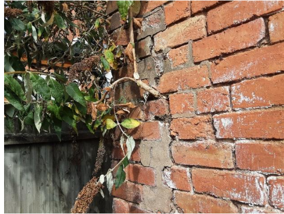
Figura 2-23: Agrietamiento de pared de ladrillo por el crecimiento de buddleja [14].
