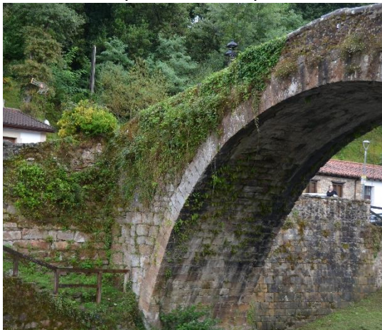
Vegetación abundante en los tímpanos y muros de estribo
