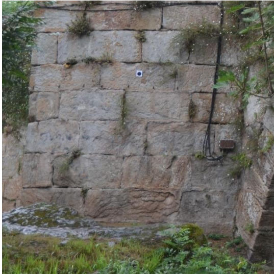
Erosión diferencial y disgregación superficial en la pila
