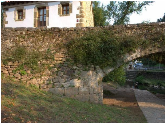
Desagregación o desintegración granular en el tímpano y muro de estribo
