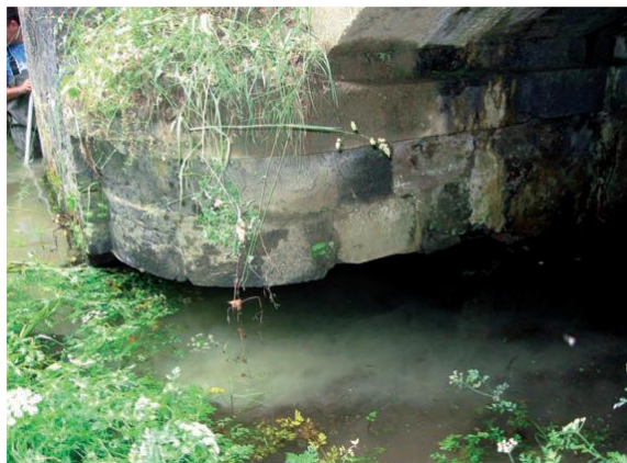
Figura 2-14: Pérdida de sillares en pie de pila [13].
