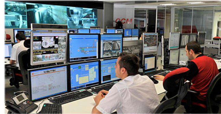
Figura 13.1. Centro de control de Transportes Metropolitanos de Barcelona
