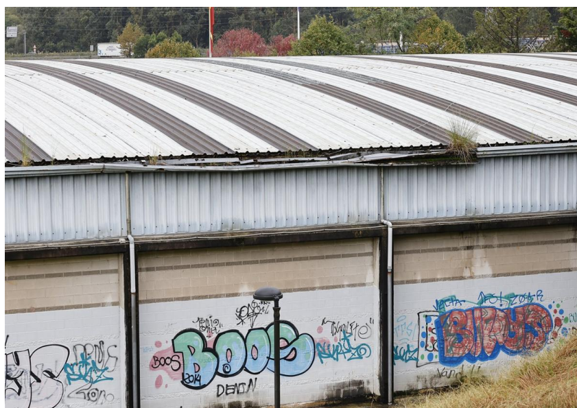
Figura 20: Estado del tejado a fecha de 23 de octubre de 2024. FUENTE: Diario Montañés.
