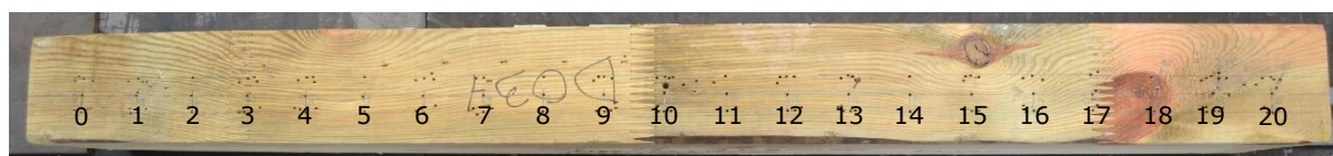
Figura 113. Cara superior de la viga sana D037 de madera de pino silvestre tanalizado GL18.
