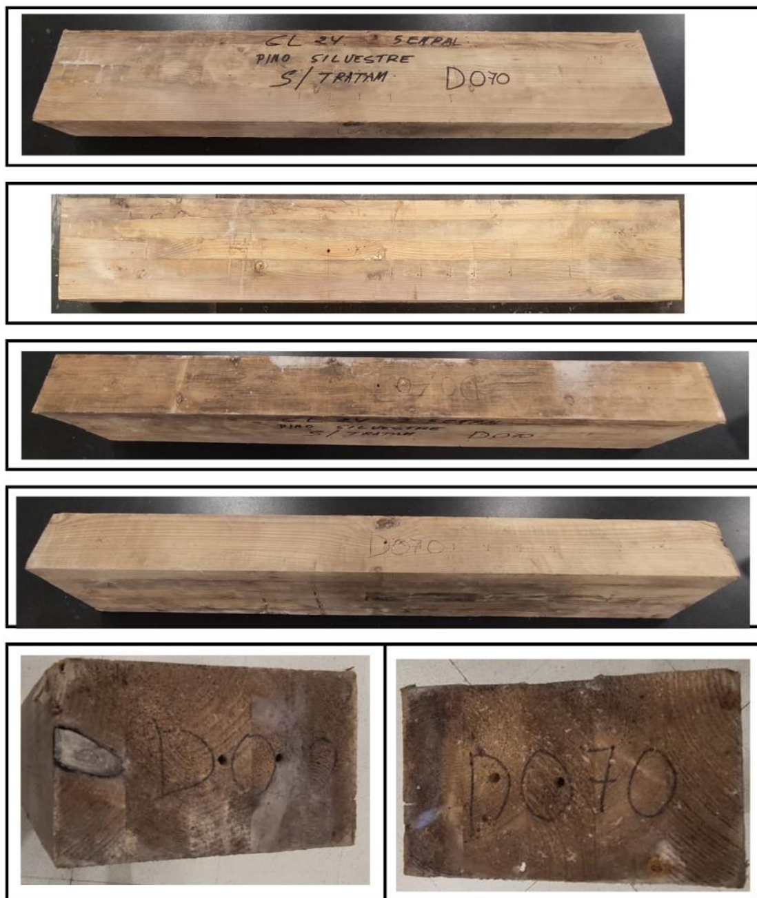
Figura 182. Estado inicial de la viga GLULAM sumergida D070 de pino silvestre sin tratamiento (GL24).
