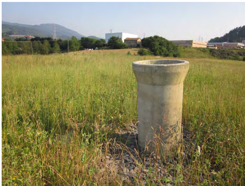
Chimenea de drenaje: tubo de hormigón rodeado de balasto
