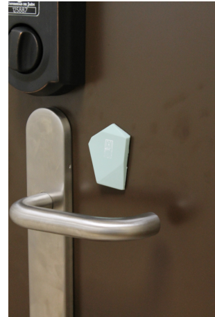
(b) Sensor BLE instalado en la puerta de entrada, utilizado para la detección de proximidad mediante señales de baja energía.
