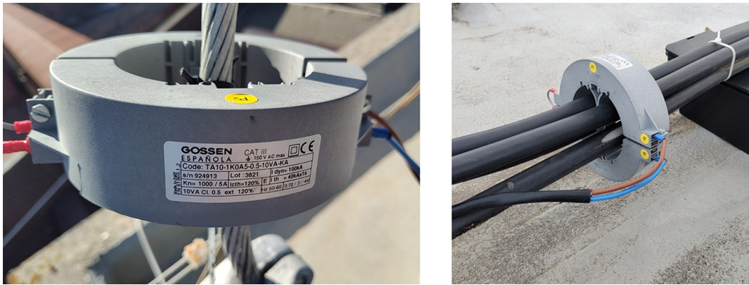
Figura 3.16: Fotografía del trafo de medida de intensidad de núcleo partido. (a) Figura izquierda: Características técnicas. (b) Figura derecha: Instalación del trafo.
