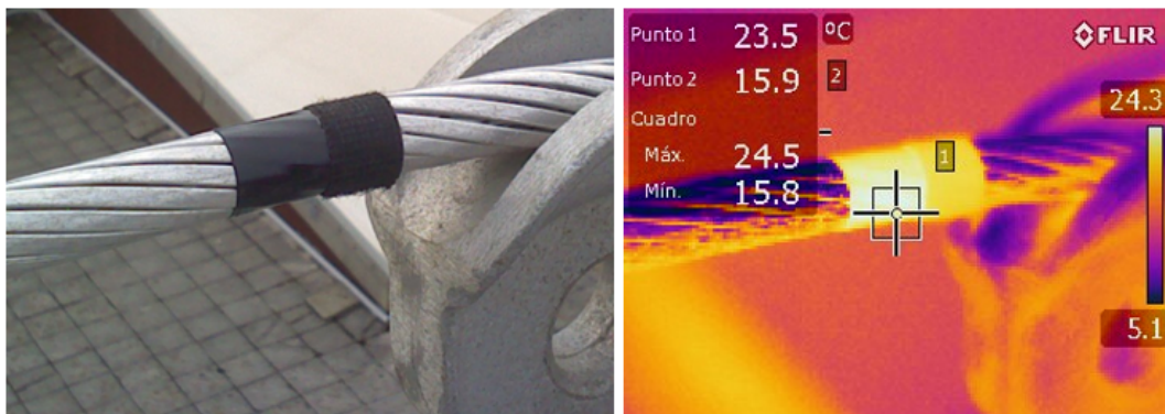
Figura 4.2: Cintas de PVC y cinta de alta temperatura instaladas cerca del herraje. (a) Figura izquierda capturada mediante una cámara convencional. (b) Figura derecha correspondiente a una fotografía con la cámara térmica.
