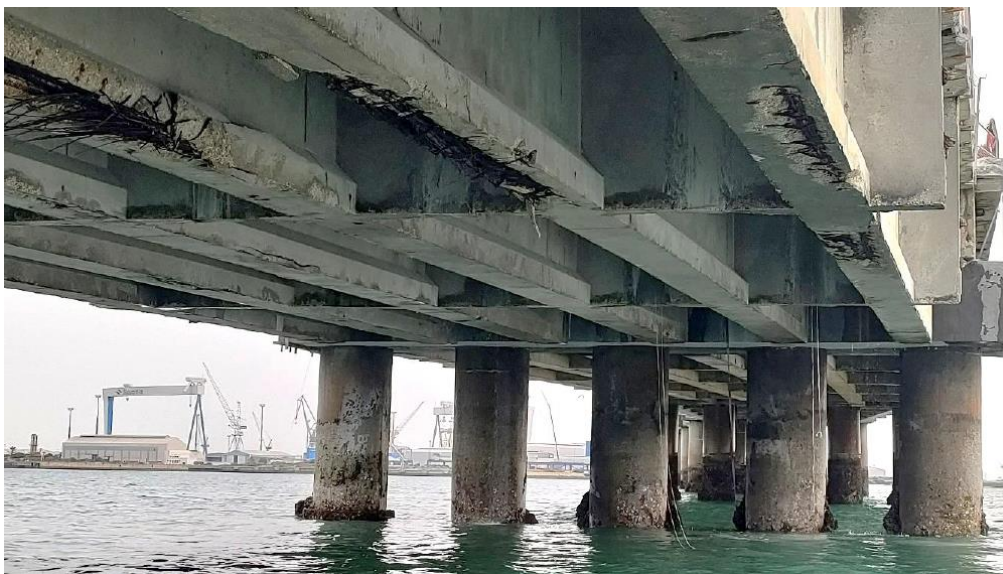
Figura 3.4 Rotura de cordones de pretensado en alas inferiores en centro de vano de vigas 1, 2 y 3 del Vano Nro 30
