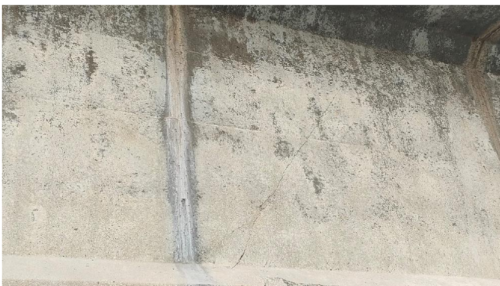
Figura 3.5 Rotura diagonal en ala inferior y fisura diagonal del alma coincidiendo con inicio de roturas en pre-tensado inferior
