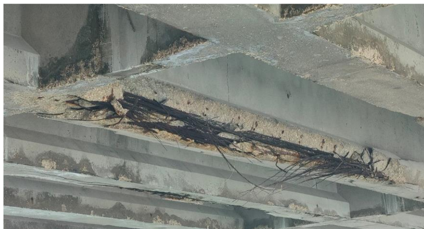
Figura 1.1 Cordones rotos con recubrimiento de hormigón desprendido [2]
