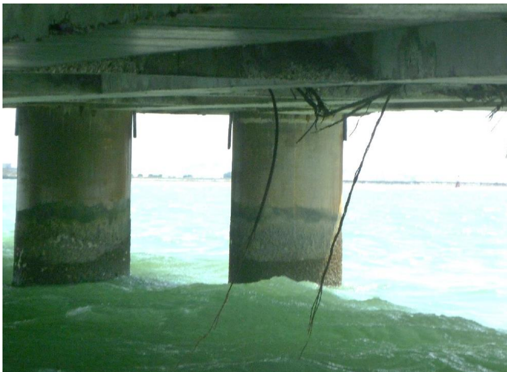
Figura 3.6 Primeras roturas de cordones de pretensado inferior en vigas en junio de 2014.
