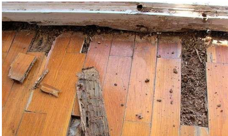
Ilustración 9: Degradación sufrida por la acción del agua y la humedad
