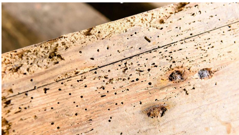
Ilustración 12: Afección por insecto xilófago (termitas)
