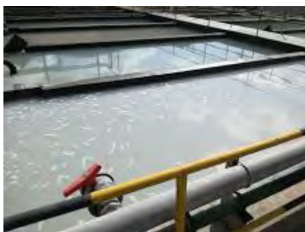
Figura 3.2 Piscinas de decantación.
