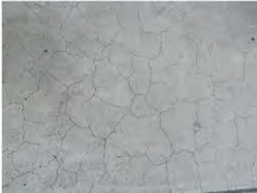
Fig. 2.50 Fisuras de retracción plástica (oficemen.com).
