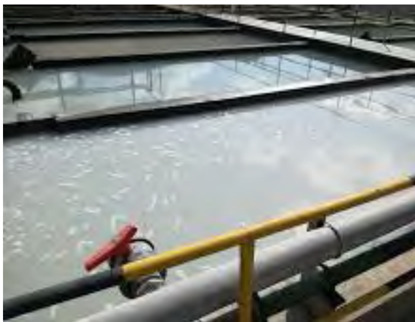
Fig. 2.21. Piscinas de decantación (Vitrinor).
