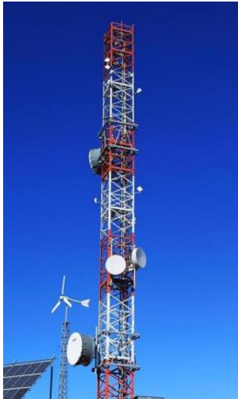
Figura 16. Torre de comunicaciones en Murcia. Fuente: Enair. Enlace: https://acortar.link/bTFe8g
