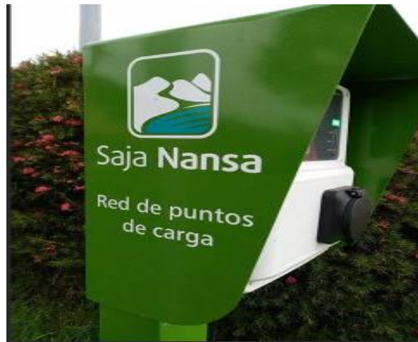
Figura 9: Punto de carga para vehículos eléctricos
