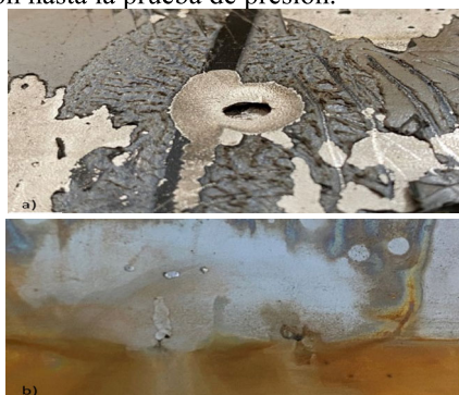
Figura 2. Picaduras en la pared de la muestra a) Cara exterior; b) Picaduras a través de la pared y otros inicios de picaduras, cara interna de la muestra.
