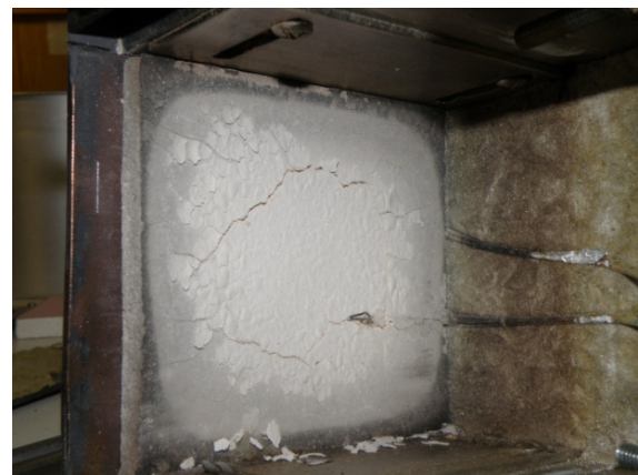
Fig. 60 Estado de la placa expuesta tras el ensayo 5
