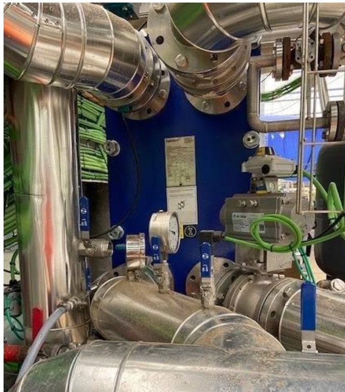
Ilustración 5 "Funcionamiento intercambiador" Fuente propia
