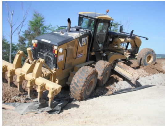
Figura 4.40: Problemas de circulación sobre el terraplén suelo-escoria producto de sobrepasar ligeramente la humedad óptima de esa mezcla.
