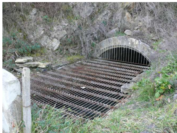
Cámara de salida
