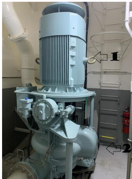
Ilustración 19 Bomba contra incendios.
