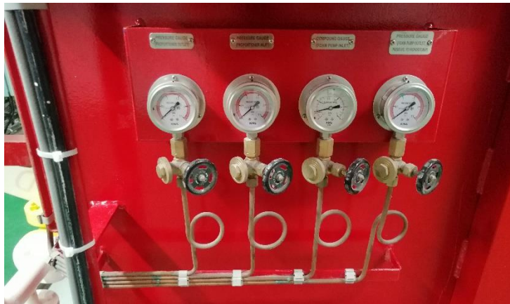
Ilustración 39 Manómetros del sistema de baja expansión.
