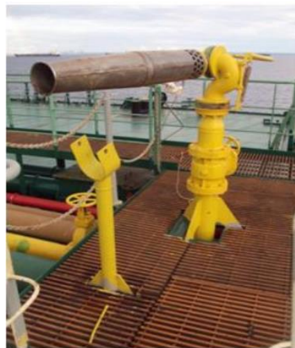
Ilustración 34 Monitor de espuma de baja expansión.
