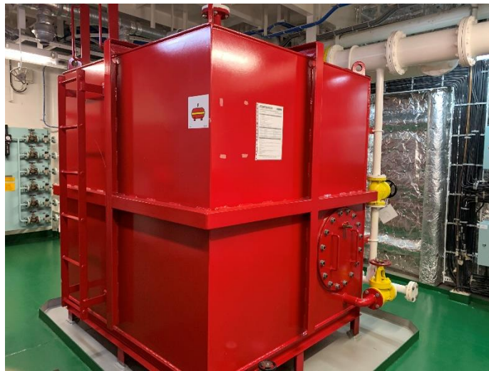
Ilustración 35 Tanque de espumógeno de baja expansión.
