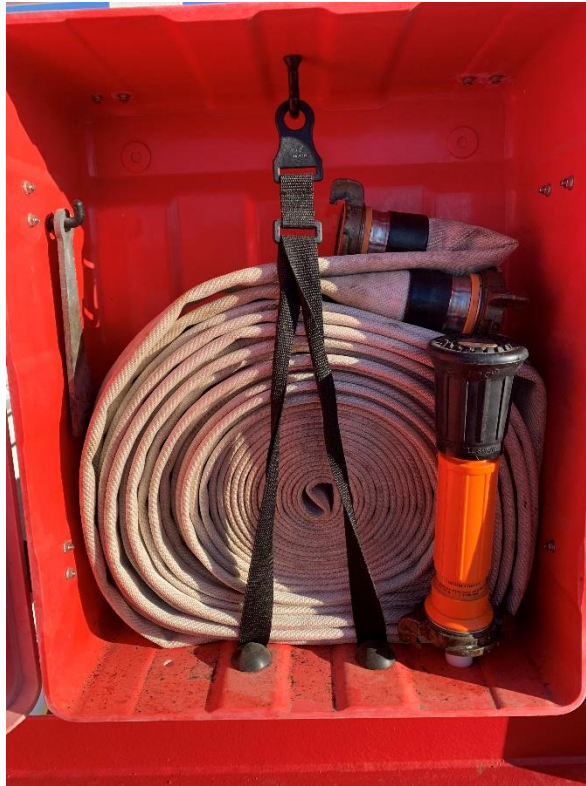
Ilustración 25 Estación contra incendios.
