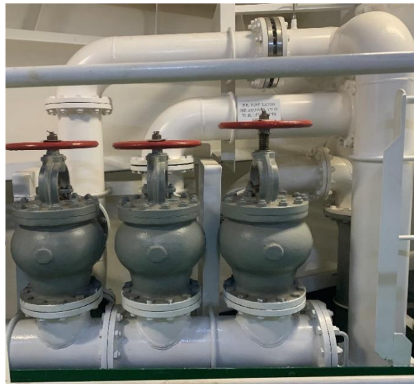
Ilustración 22 Piano de válvulas.
