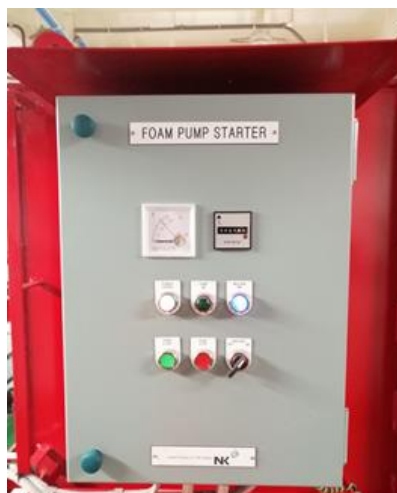
Ilustración 38 Panel de control de la bomba del espumógeno.
