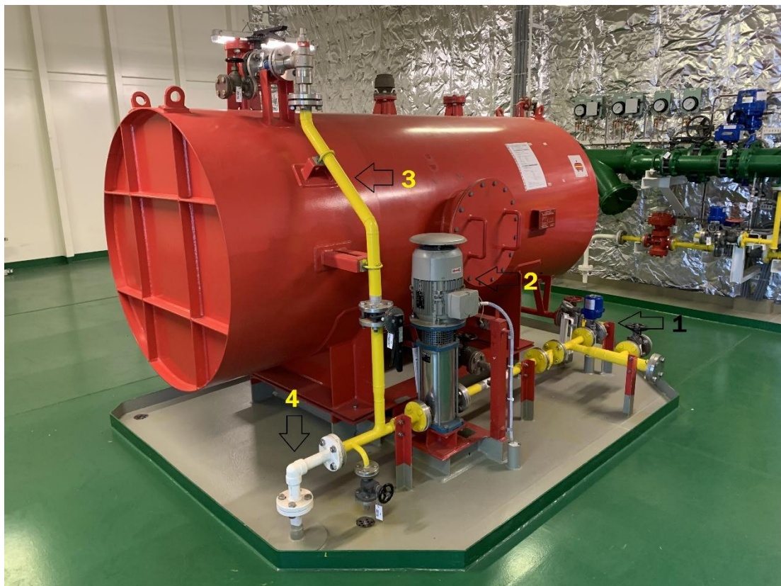
Ilustración 27 Tanque de espumógeno de la espuma de alta expansión.
