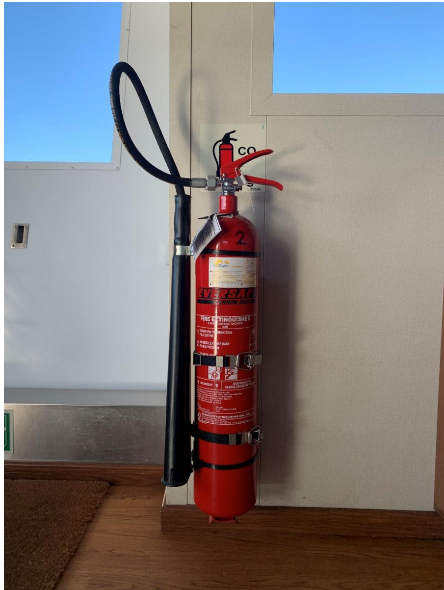
Ilustración 17 Extintor de CO2.
