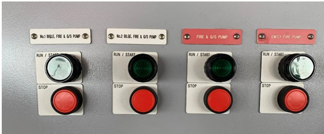
Ilustración 21 Panel de control de las bombas del puente.
