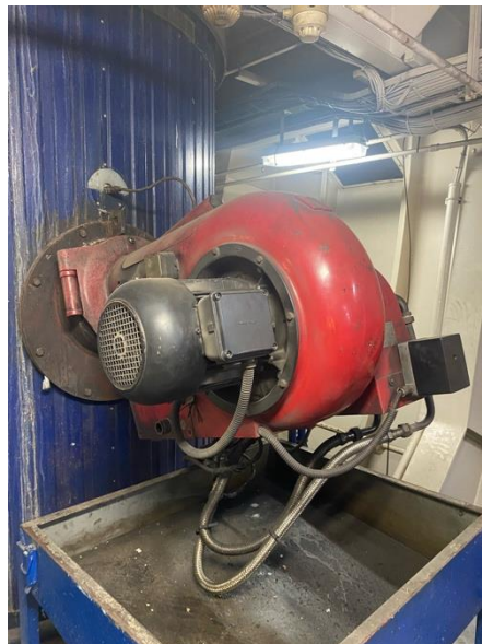
Imagen 7: Quemador de la caldera. Fuente propia
