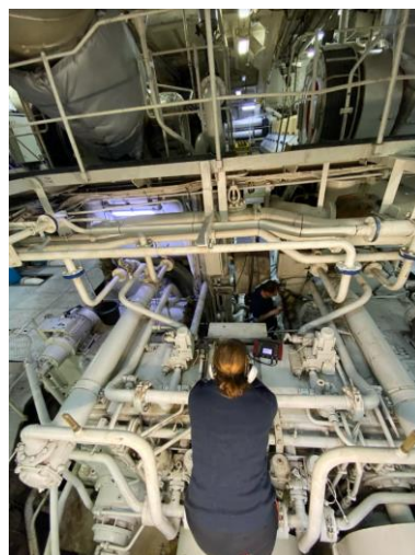
Imagen 4: Reductora TCH350. Fuente propia.
