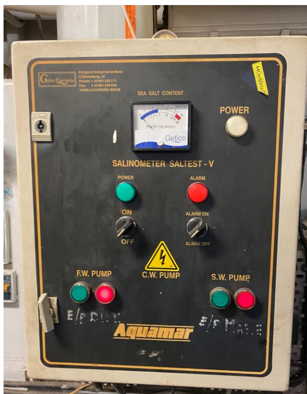
Imagen 75: Cuadro eléctrico Evaporador AQ 16-20. Fuente propia.
