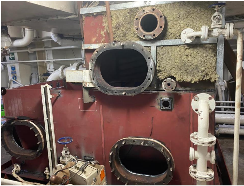
Imagen 11: Tanque filtro y obs.purgas. Fuente propia
