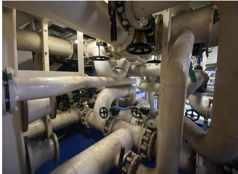
Imagen 28: Válvulas de control enfriador de placas MM.PP. Fuente propia.
