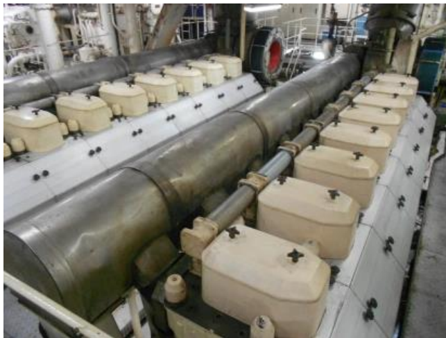
Imagen 1: Motores Principales (3 y 4, estribor). Fuente: WordPress.com
