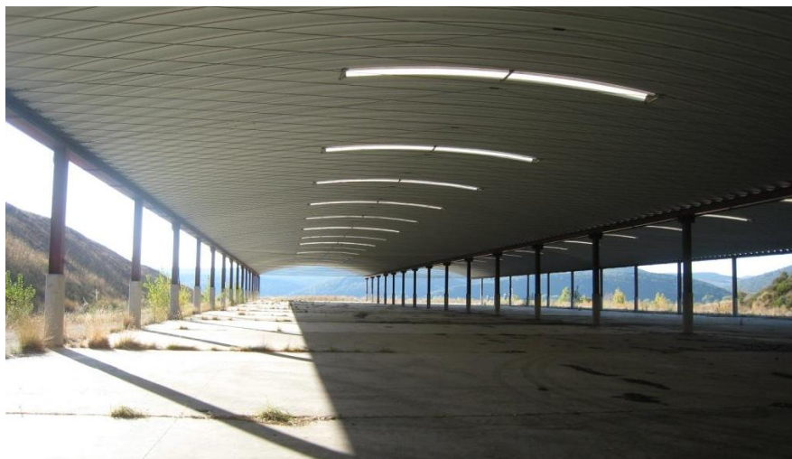
Figura 2.3 Interior planta de compostaje
