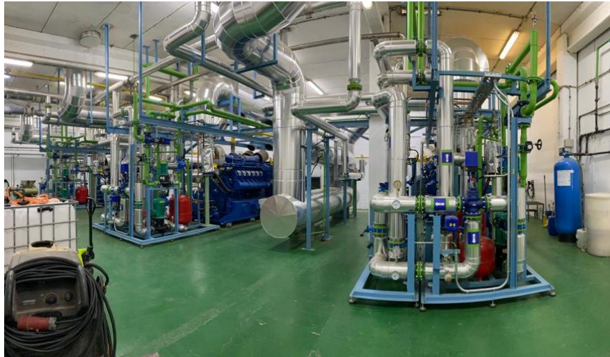
Figura 2.1 Moto-generadores de la planta de cogeneración
