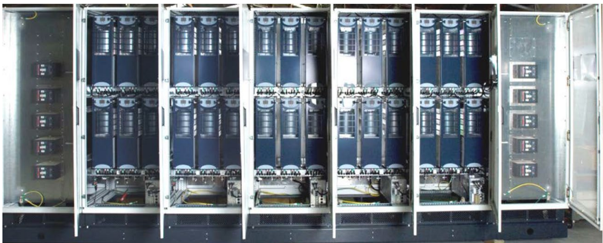
Ilustración 26: Ejemplo de instalación un convertidor de frecuencia de 1875 kVA de potencia. Fuente: ABB
