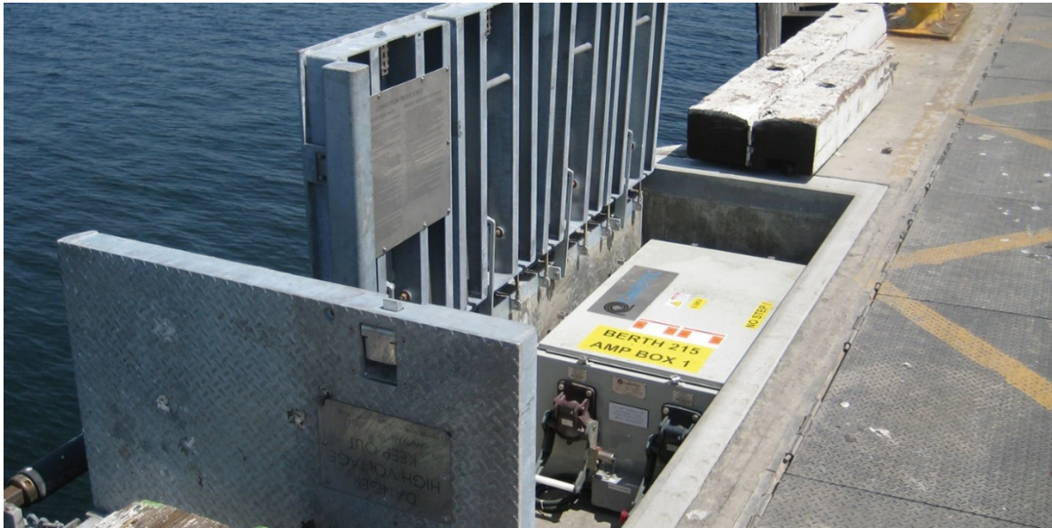
Ilustración 28: Punto de conexión con tapa protectora. Fuente: Cavotec
