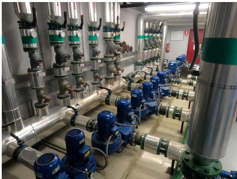
ILUSTRACIÓN 27 Grupo de bombas en línea en casetón de calderas y colector de retorno de A.C.S en primer plano.
