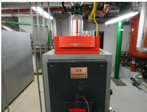
ILUSTRACIÓN 15 Caldera N°1 VIESMANN VITOPLEX 100
