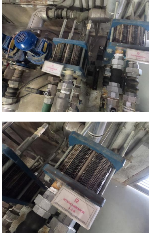
ILUSTRACIÓN 17 Vista en conjunto intercambiadores de placas I1-I2 –Detalle I2-
