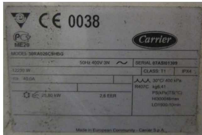
ILUSTRACIÓN 21 Enfriadora Carrier 30RA026C9HB. Casetón de calderas.
