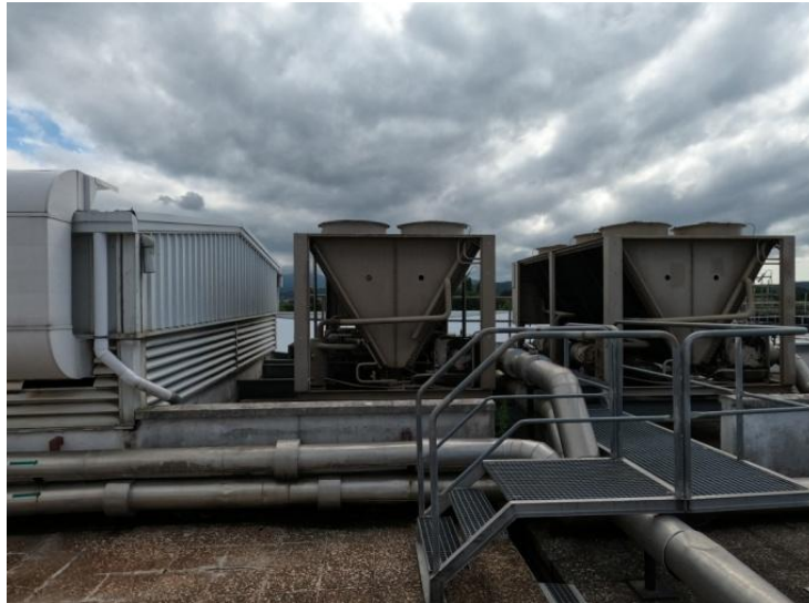
ILUSTRACIÓN 20 Detalle enfriadoras junto a casetón de cubierta.
