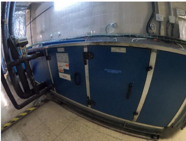
(I, II y III) Climatizadoras CL-13, CL-19 y CL-27. Casetón de calderas. Unidades Termoven.
