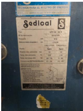
Detalle características intercambiador agua-agua. Presión y Temp.
