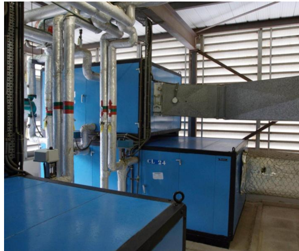
ILUSTRACIÓN 22 Climatizadora 34 TERMOVEN CL 2018 Módulos -Casetón Consultas-
