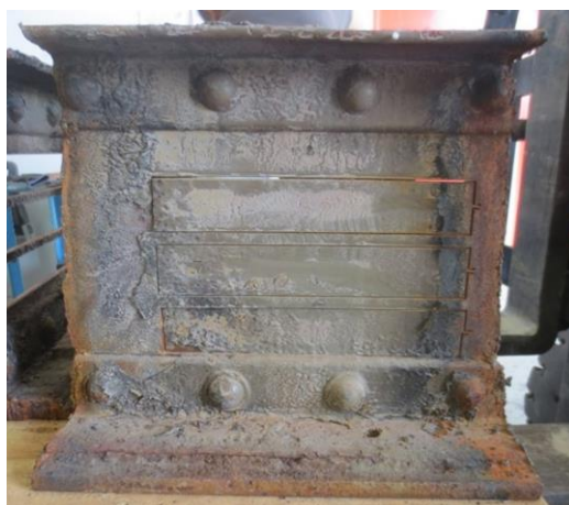
Figura 11. Placas de hierro pudelado cortadas del alma de largueros roblonados del puente de Redondela.
