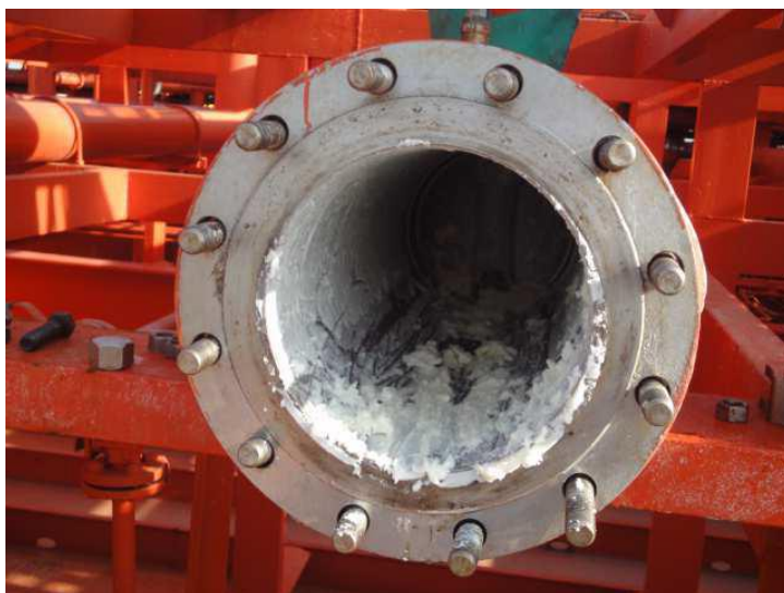
Ilustración 16: Conexión de manifold tras la descarga de aceites vegetales. Fuente: Marflet Marine Internacional S.A.
