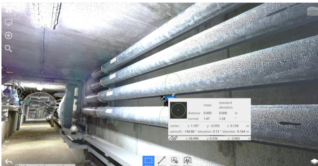
Figura 16: Uso de la herramienta Pipe Snap de ReCap para calcular el diámetro de la tubería
