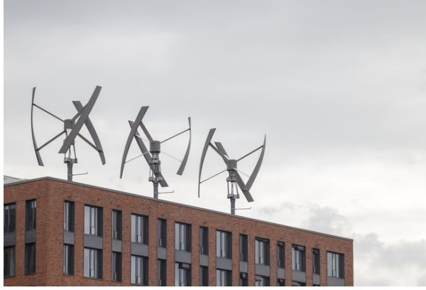
Figura 1.4: Instalación minieólica en un edificio de Hamburgo, Alemania [9]
