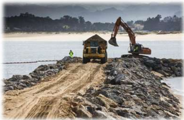
Imagen 12. Impacto creado durante la construcción de un dique
