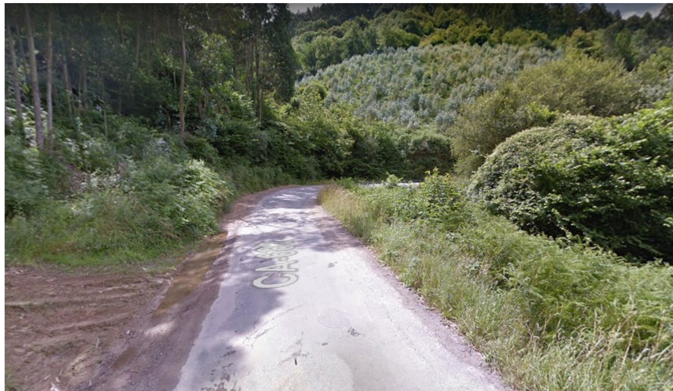
Figura 3. Mal estado de pavimento. Falta de señalización y de elementos de drenaje. Radio que no cumple la normativa.
