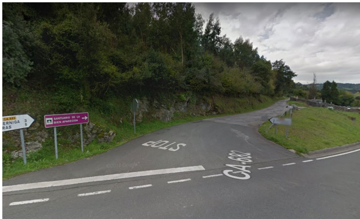
Figura 1. Intersección CA-682 con CA-258. Mala visibilidad e incumplimiento de radio de giro.
