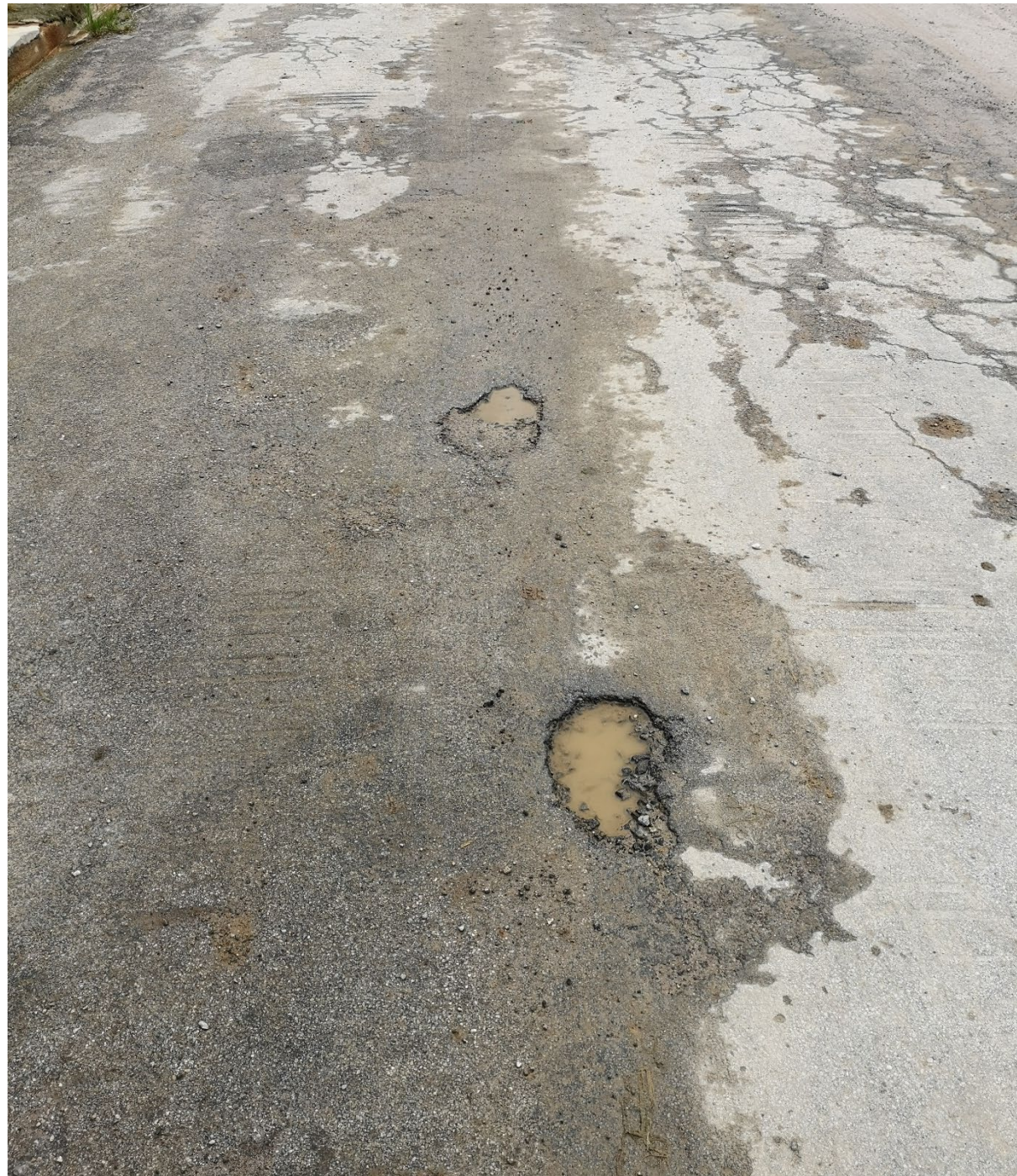
Figura 7. Mal estado de pavimento.
