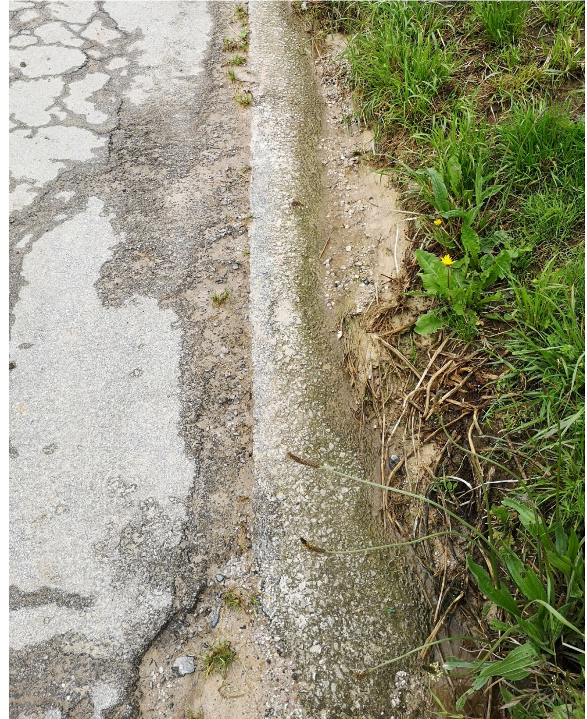
Figura 8. Mal estado de pavimento. Tamaña de cuneta insuficiente además de obstrucción de esta.
