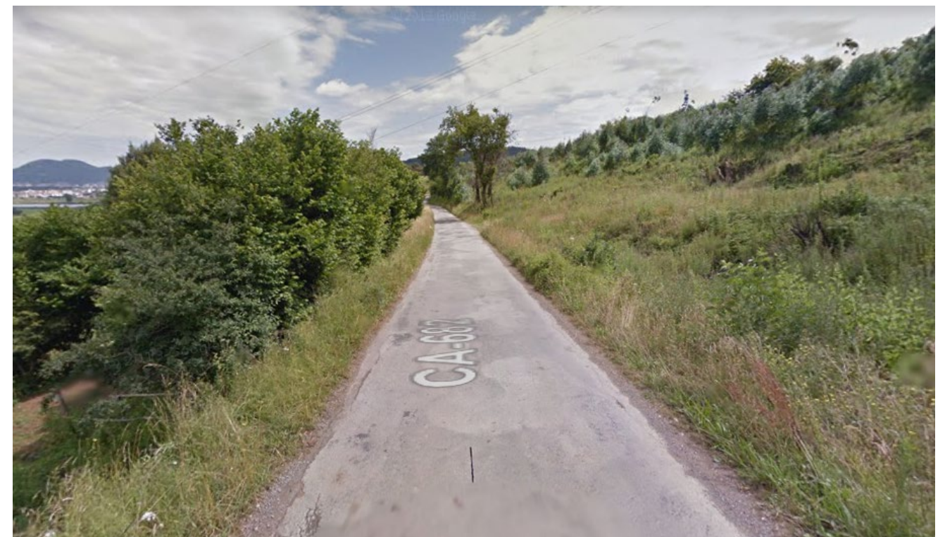
Figura 2. Mal estado de pavimento. Falta de señalización y de elementos de drenaje.
