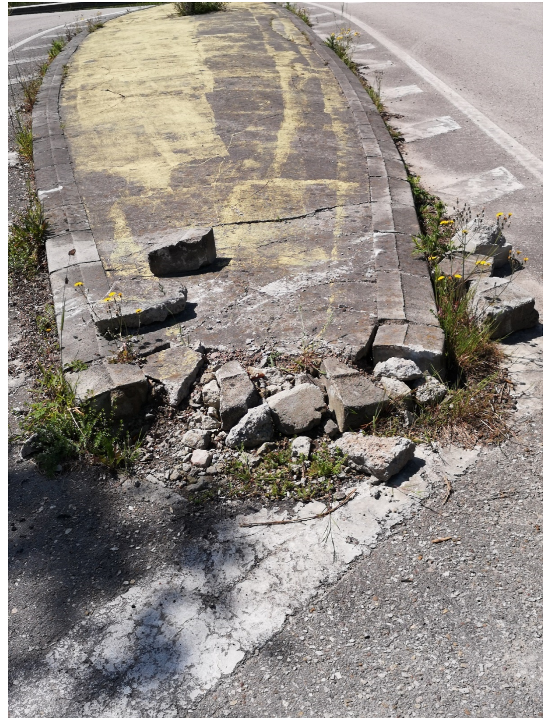
Figura 10. Isleta de la intersección CA-682 con la CA-683 en mal estado.
