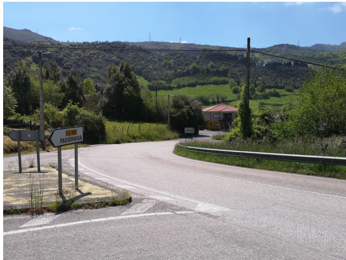
Figura 13. Intersección de CA-682 con CA-683 de mala visibilidad.
