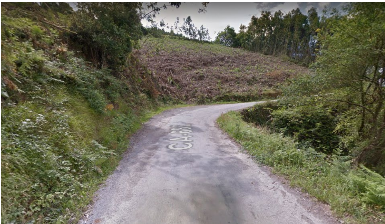
Figura 5. Mal estado de pavimento. Falta de señalización y de elementos de drenaje. Radio que no cumple la normativa.
