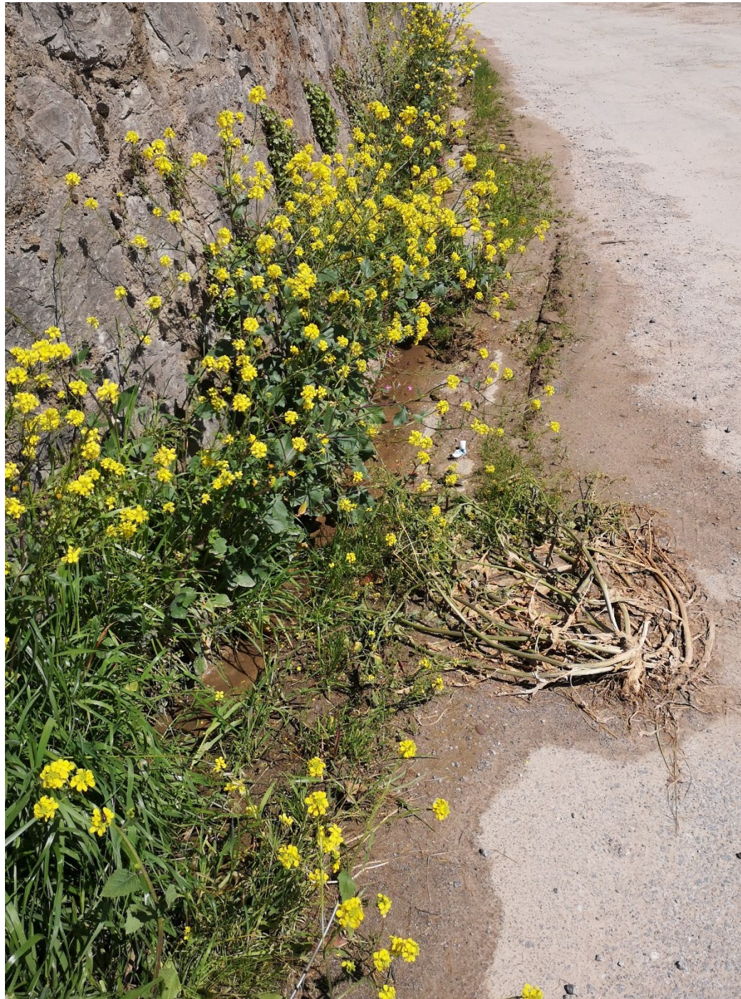
Figura 9. Cuneta totalmente obstruida.
