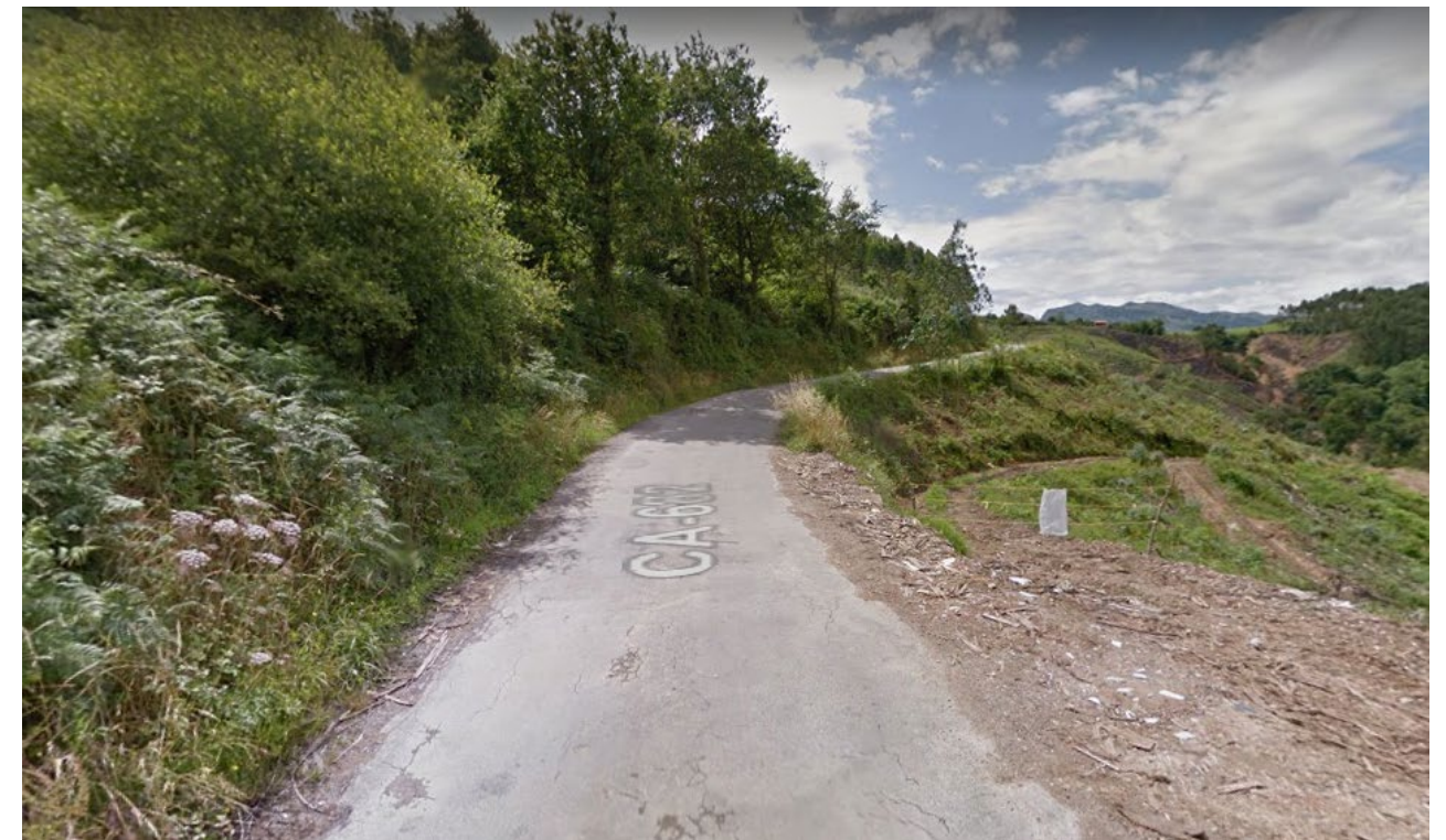
Figura 4. Mal estado de pavimento. Falta de señalización y de elementos de drenaje.
