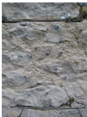
Agrietamiento surgido alo largo del ensayo
