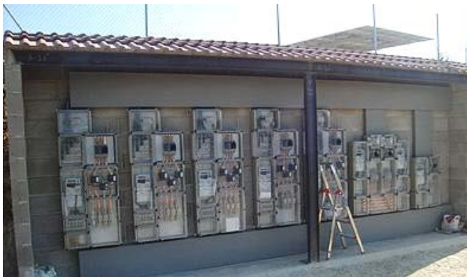
Ilustración 32: Equipos de medida de instalación fotovoltaica. Fuente: www.soliclima.es
