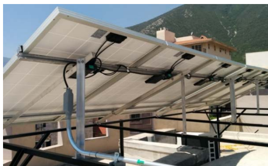
Ilustración 30: Inversor FV. Fuente: www.cemaer.org
