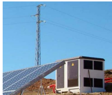
Ilustración 31: Centro de transformación. Fuente: PFSA
