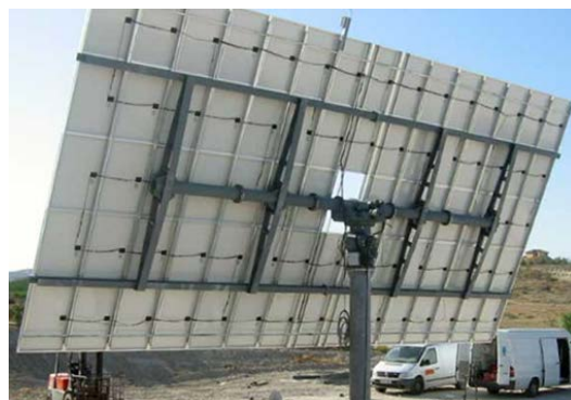
Ilustración 37: Estructura solar con seguimiento de dos ejes. (Instalación Murcia). Fuente: www.solener.com
