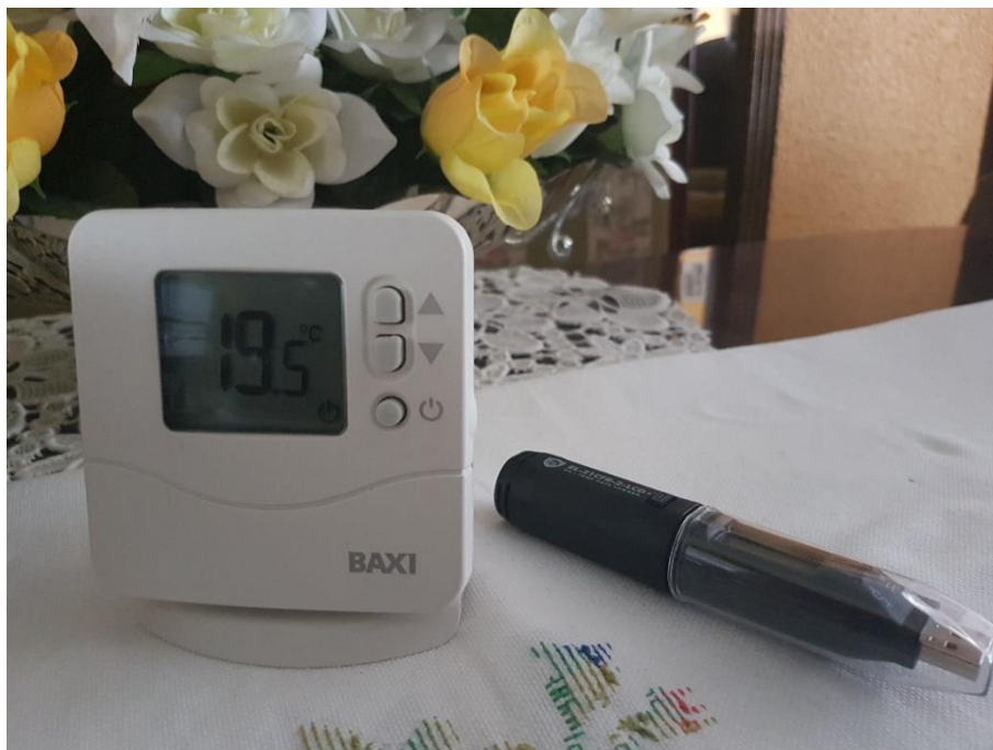
Figura 58. Termostato digital y sensor térmico en la vivienda 1
