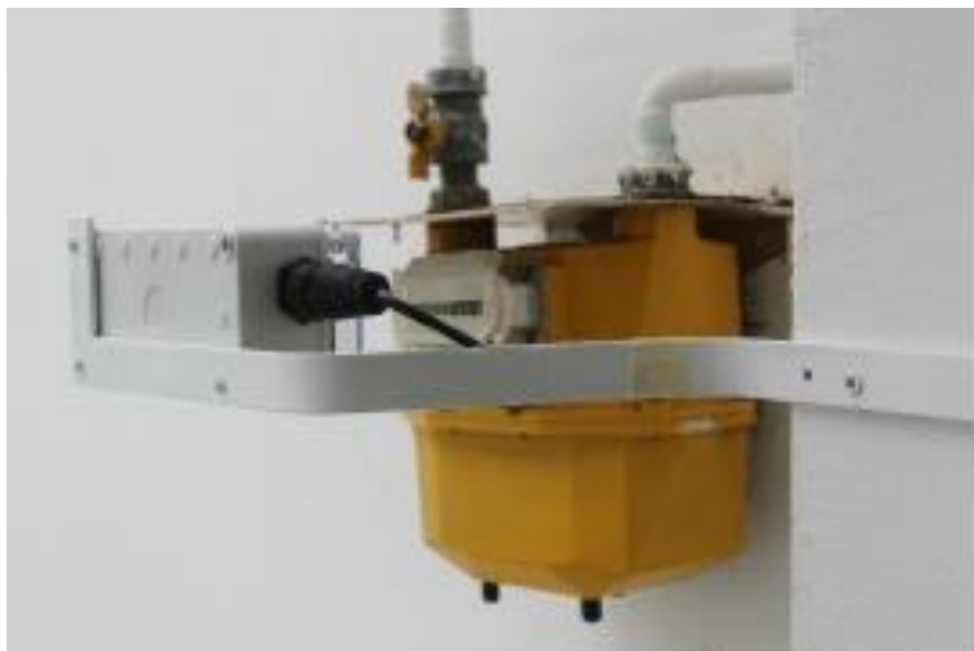
Figura 73. Colocación final del conjunto para la lectura del contador de gas
